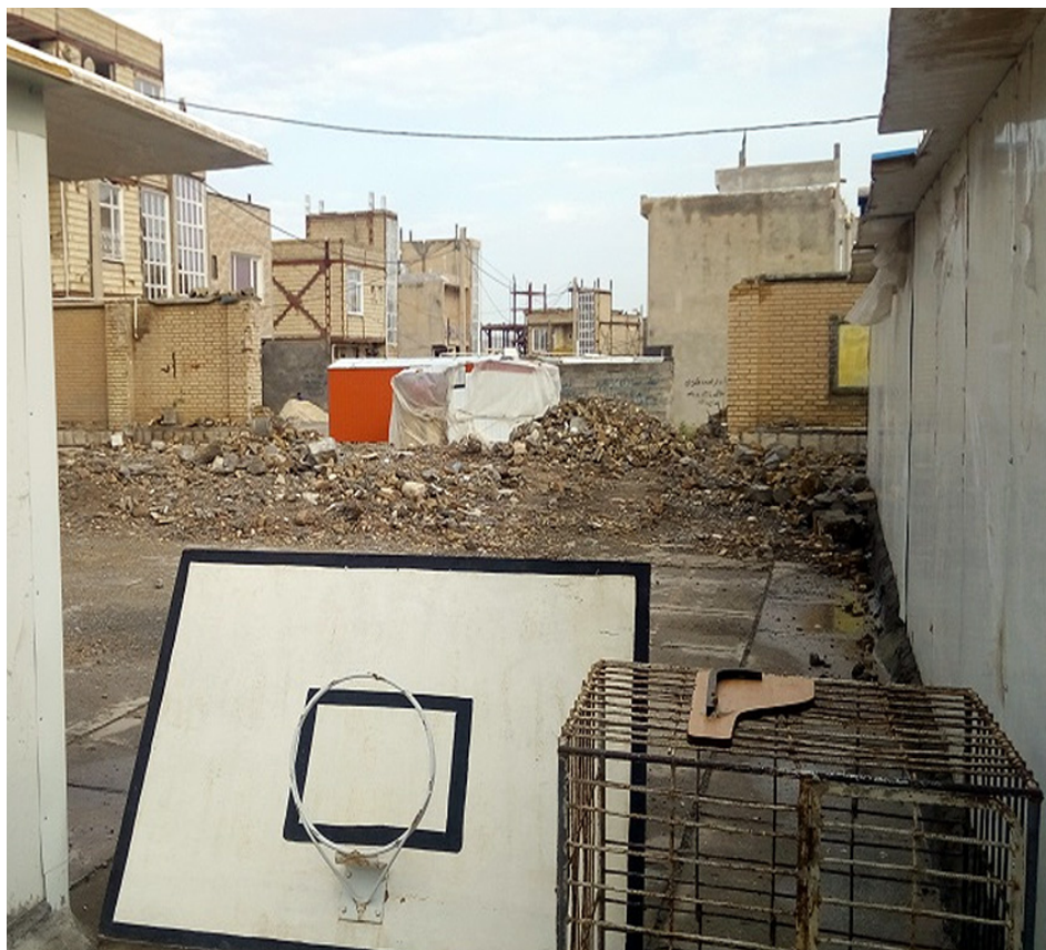
تصویر ۳. تخریب فضا و امکانات ورزشی مدرسه و انباشتگی نخاله‌های ساختمانی
